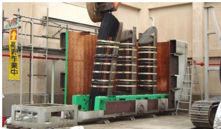
大型変圧器（トランス）
